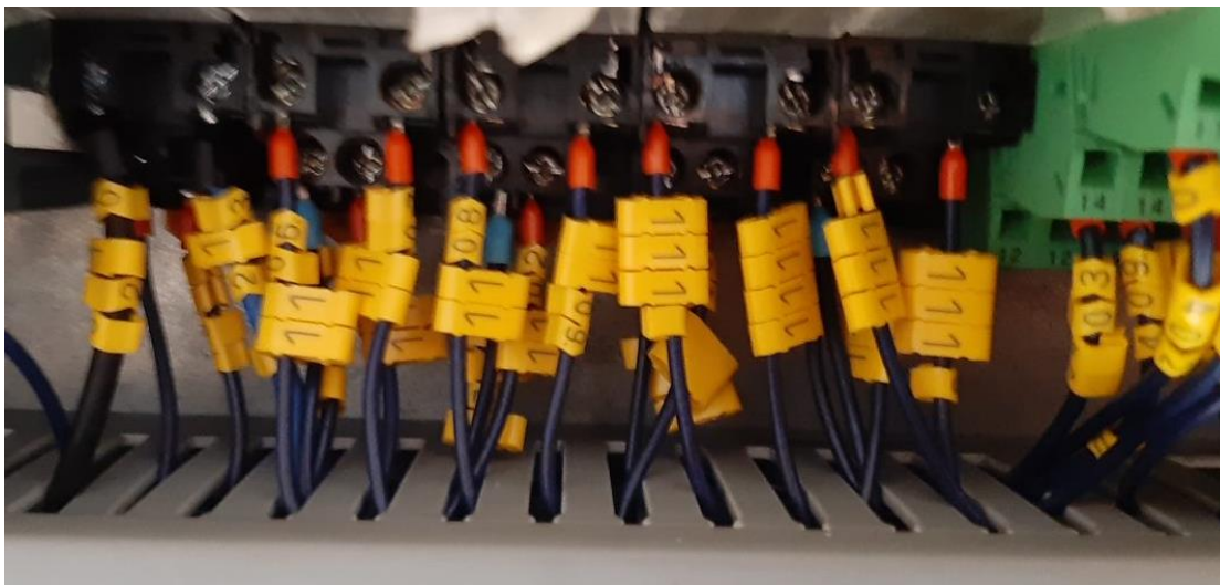
Figuur 5.6-1: Draadnummers aangebracht in elektrische kast
