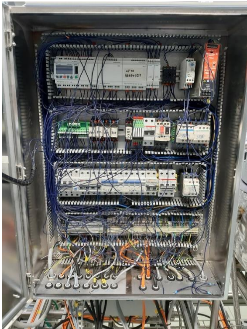
Figuur 5.5-1: Schakelkast begin dit jaar
