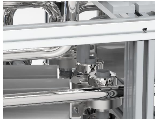
Figuur 3.7-12: Leiding sluit niet goed aan
