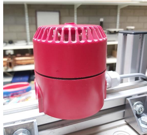
Figuur 5.2-2: Auditieve melder op brouwinstallatie
