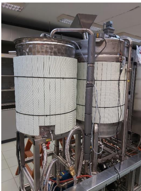
Figuur 3.8-3: Isolatie rond het buffervat, de maischketel en de (toevoer)leiding van het buffervat
